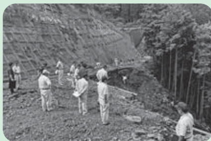
小川・石打谷線(横野側) 台風10号被災現場 今後災害復旧対応
