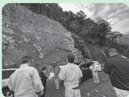
令和5年度明許線越林道 長谷・児原線災害復旧工事 豪雨災害1号箇所
